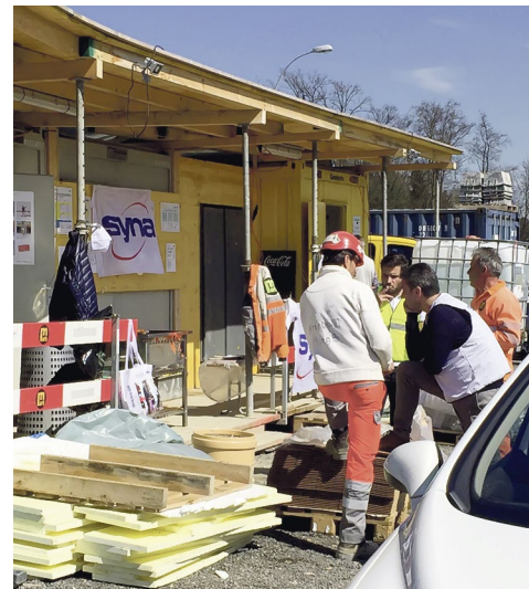
Gespräche in ungezwungener Atmosphäre kommen bei den Bauarbeitern gut an. Bild: Katja Blust
